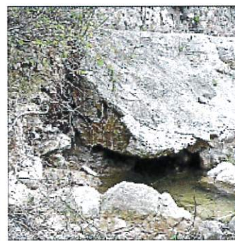
Dégradation d'un enrochement.
